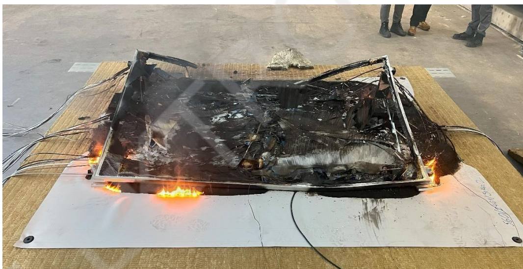
Slika 21 Razbijena fotonaponska ploča i ostaci plamena na krovnoj membrani (Fotografija 050522d-031)
